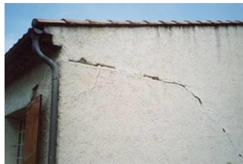
Fissuration dues aux mouvements de terrain
